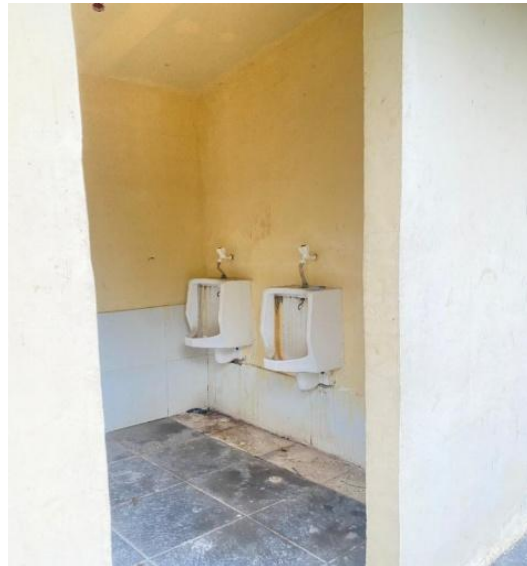
Gambar 3. Kondisi Toilet Pria yang Tidak Terawat
