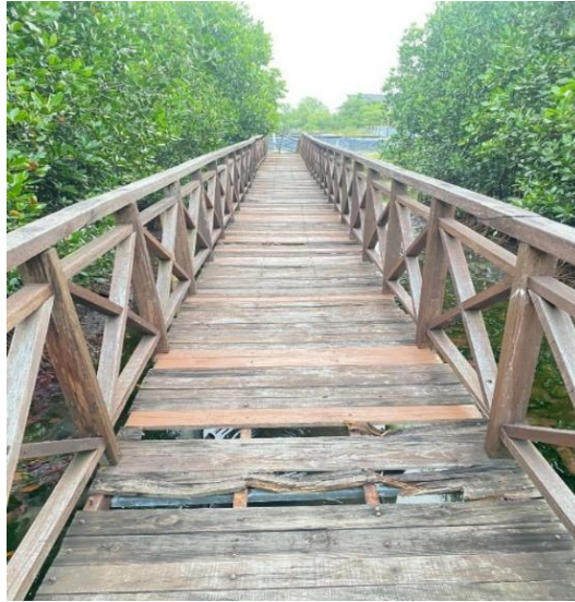
Gambar 2. Kondisi papan kayu yang rusak
